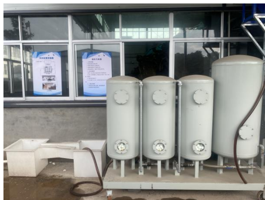
废水处理设施
