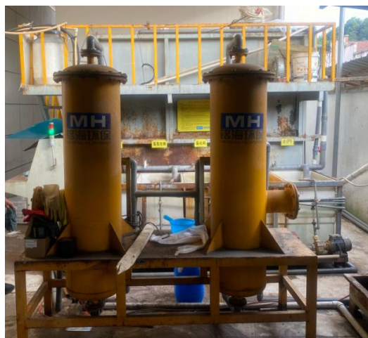
废水处理设施
