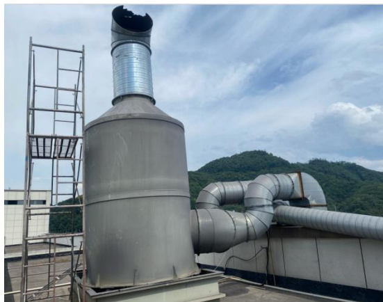
抛光粉尘处理设施
