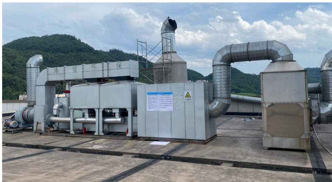
“水喷淋+干式过滤+活性炭吸附+脱附+催化燃烧”废气处理设施（部分）
