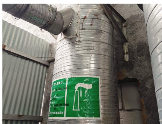
喷漆废气、调漆废气、烘干废气、天然气燃烧废气排气筒（DA003）
