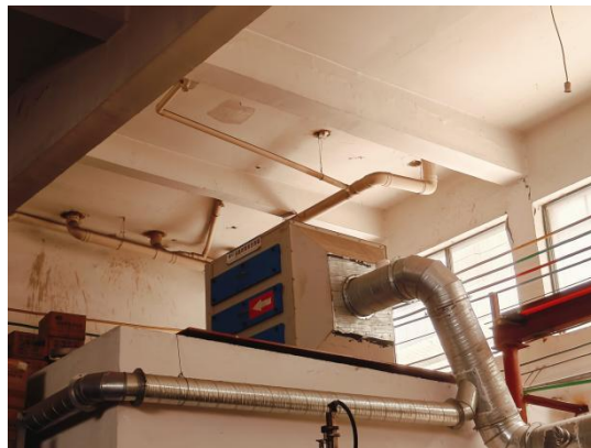
注塑废气处理设施及排气筒（DA004）
