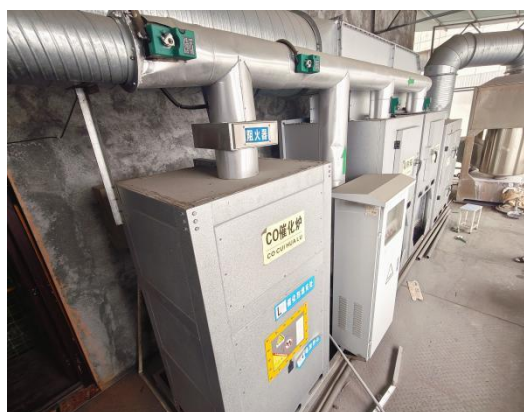
喷漆废气、调漆废气、烘干废气、天然气燃烧废气处理设施
