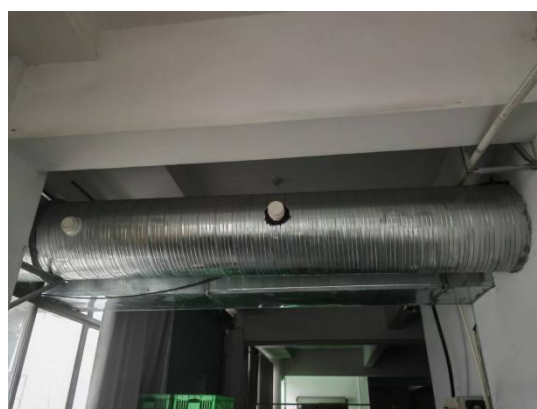
抛光废气排气筒（DA002）
