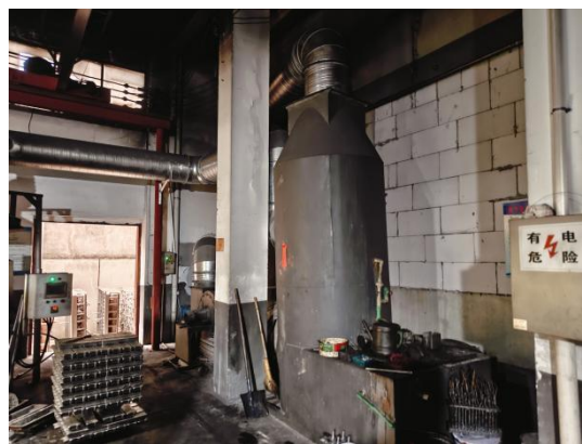
熔化烟尘、脱模废气、压铸废气、天然气燃烧废气处理设施及排气筒（DA001）
