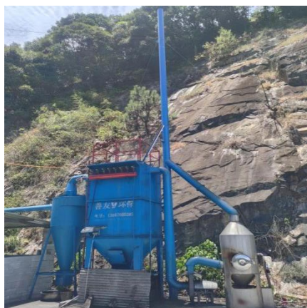
锅炉燃烧废气排气筒（DA003）
